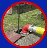
Bouche Incendie (BI)
